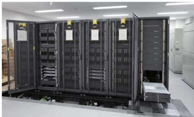
▲建設が進む「京」(計算科学研究機構)、FOCUSとは渡り廊下で接続される ▲FOCUS内に設置が進むスパコン
