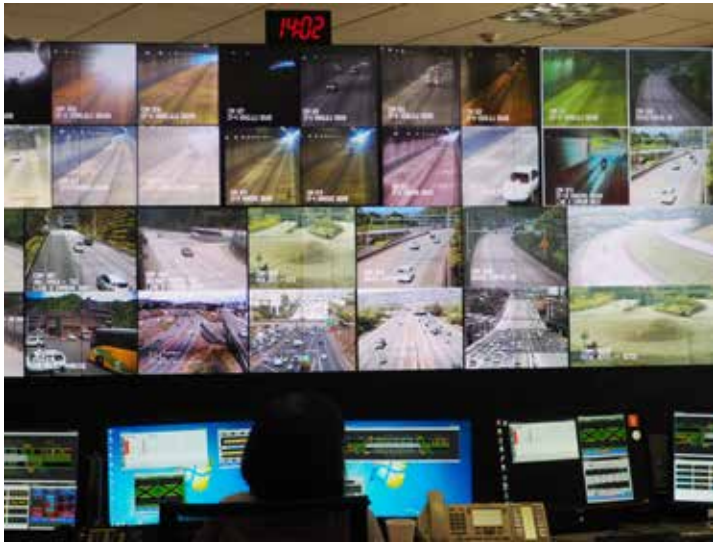
■ずらりとモニターが並ぶ監視室
