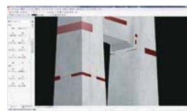
▲損傷(左)／補修後(右)
