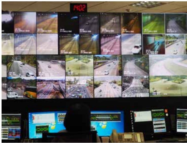
■ずらりとモニターが並ぶ監視室
