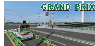
第12回「夜間工事におけるVR交通規制シミュレーション」株式会社岩崎 企画調査部
