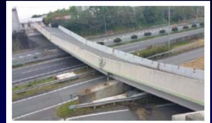
九州自動車道のロッキング橋梁の落橋 国土交通省「道路における震災対策」
