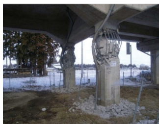
図1 高架橋の損傷状況 2)
